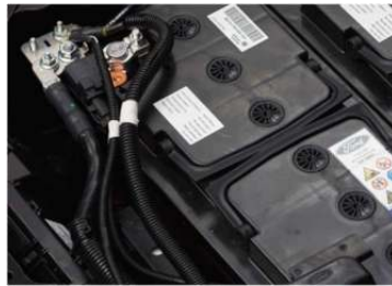
2 AGM-Tiefzyklus-Hochleistungs-Batterien, 80Ah fürs Kfz, 95Ah für Camping (Licht, Kühlbox, 230V,...)
